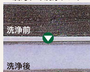
油汚れの洗浄テスト
